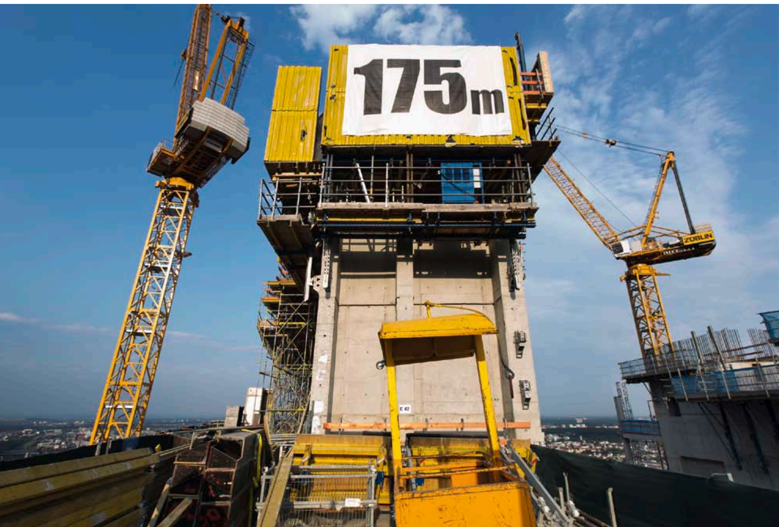
Det dubbla kontorstornen var 175 m högt i juli 2012. På östra sidan av höghuset pågår arbetena med ramverket för inglasningen av atriumet.
